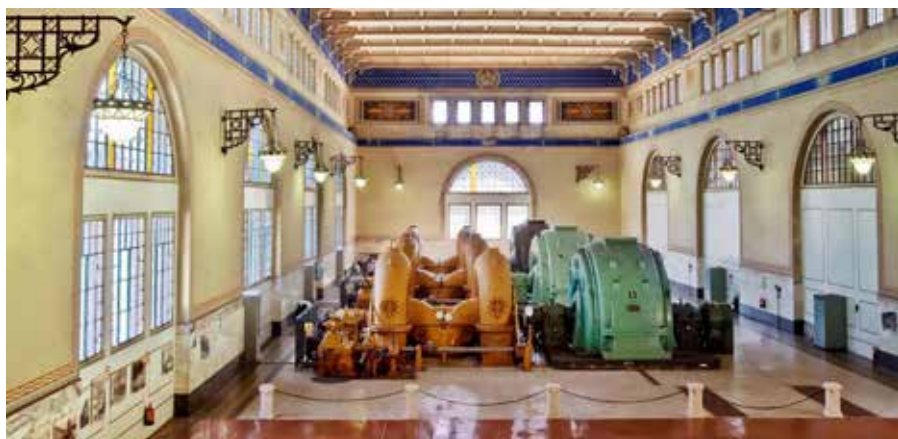
Figura 41 - La sala macchina della centrale Nove 25 a Nove (Tv), 1925
